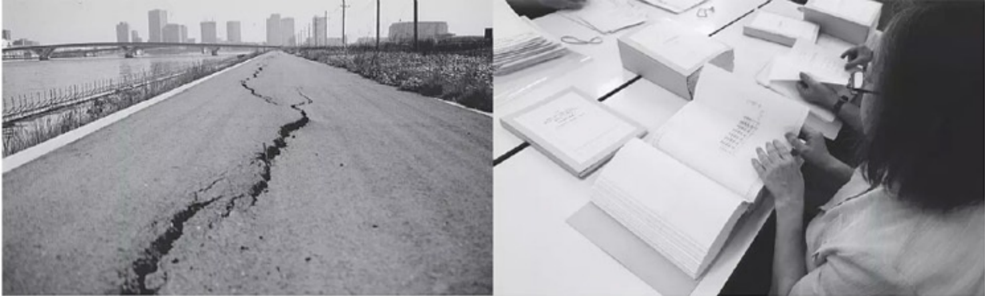
6街区北側にある耐震護岸の歩道は東日本大震災で大きな亀裂が入っていた。液状化で敷地の土圧が護岸を押す「側方流動」が起きた
